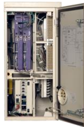
ODC-100 Front (remote power)
